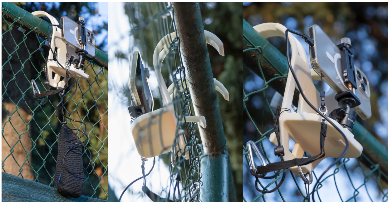
Slika 7.3 Nosač montiran na poprečnu cijev ograde igrališta
