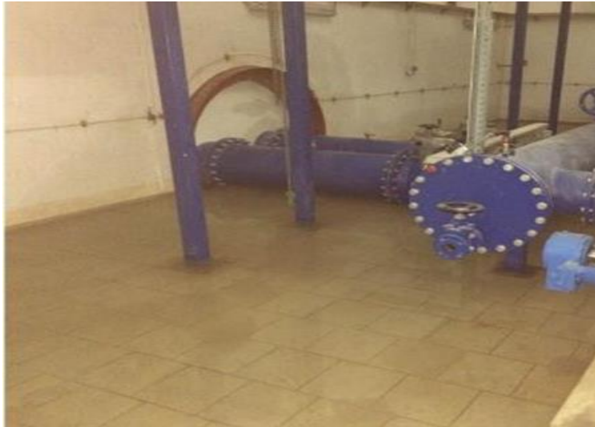
Slika 2.11. Cijevi na ulazu u crpnu stanicu
