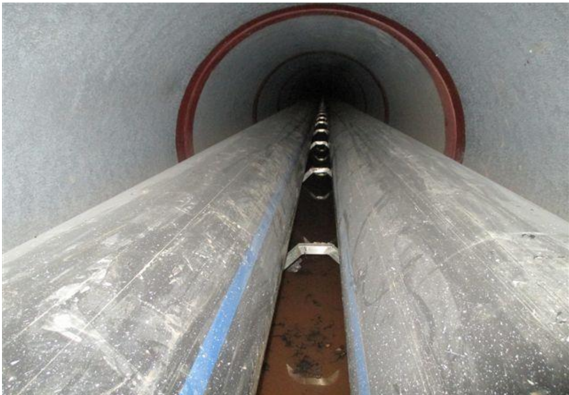
Slika 2.8. Dovodne cijevi u tunelu
