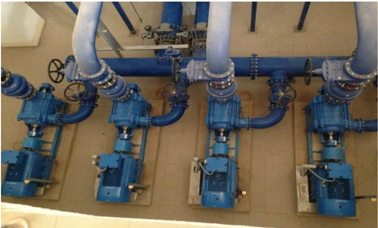
Slika 2.5. Četiri visokotlačne centrifugalne pumpe
