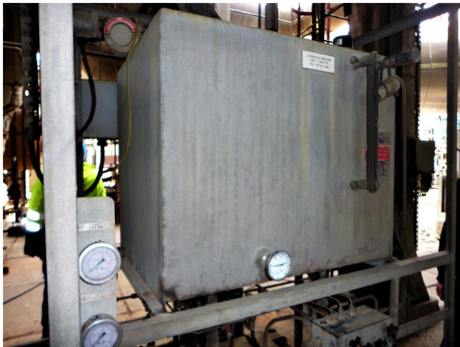
Slika 3-7 Spremnik ulja hidrauličkog agregata
