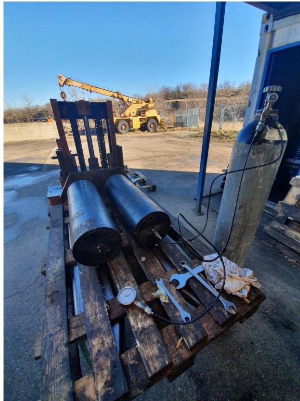
Slika 4-6 Ispitivanje hidrauličkih akumulatora
