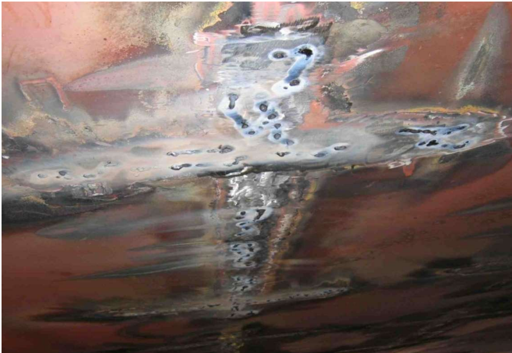
Slika 2-9. Izgled oštećenja popravljenih zavarivanjem. Izvor: autor
