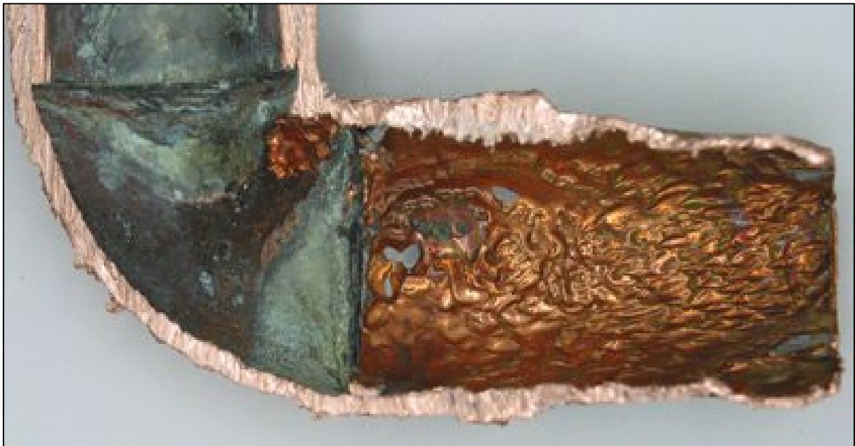
Slika 5.19. Erozijska korozija bakrene cijevi [51]
