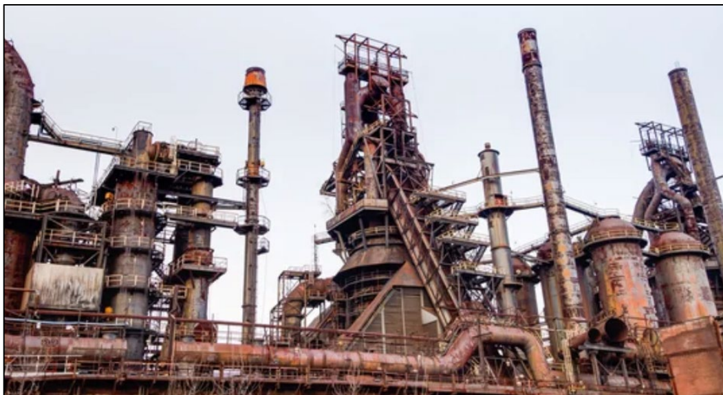
Slika 4.9. Korozija postrojenja u industrijskoj atmosferi [22]
