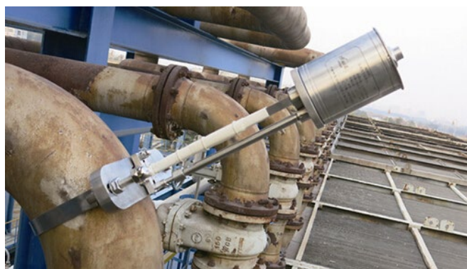
Slika 4.26. Mrežno ultrazvučno ispitivanje korozije na koljenu cjevovoda [39]
