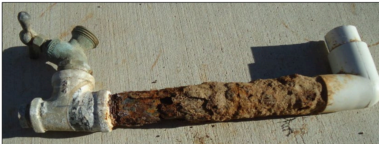
Slika 5.4. Galvanska korozija pocinčane čelične cijevi [41]
