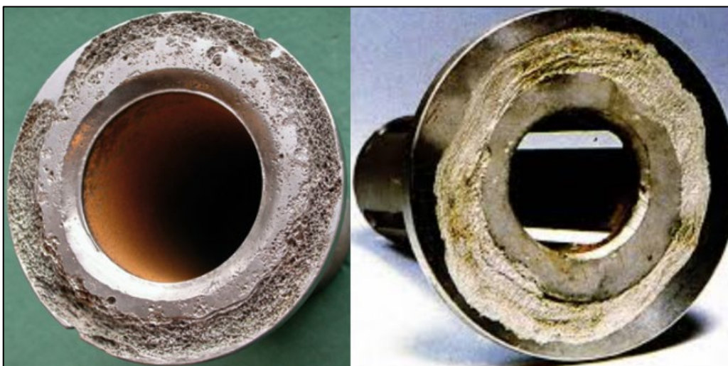
Slika 5.7. Korozija prirubnica s brtvom [43]
