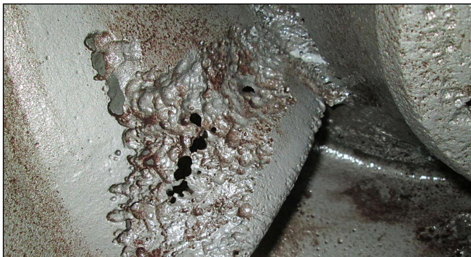
Slika 5.21. Kavitacijska korozija rotora pumpe [53]
