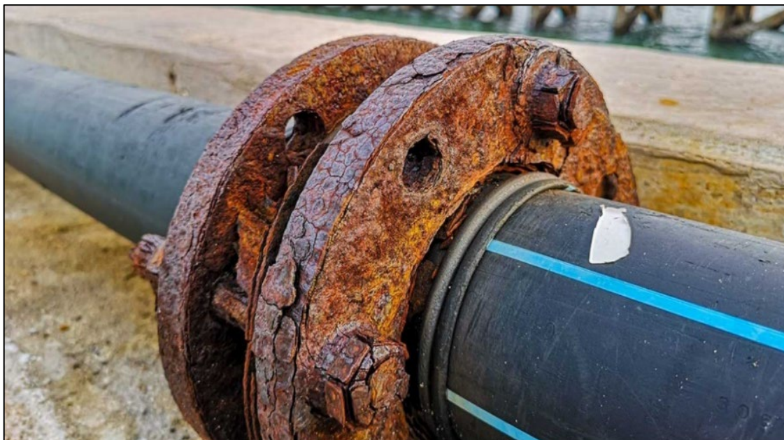
Slika 2.2. Korozija spoja dviju PEHD (alkaten) cijevi [7]
