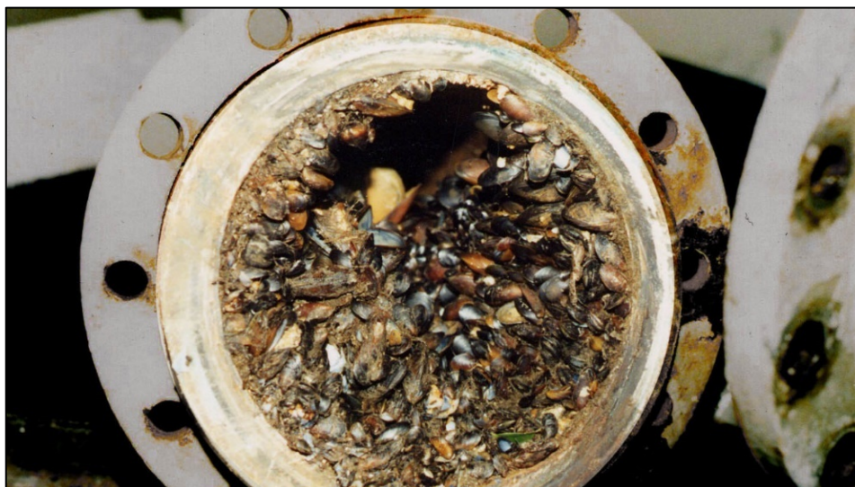
Slika 4.15. Biološko obrastanje u cijevnim sustavima broda [27]
