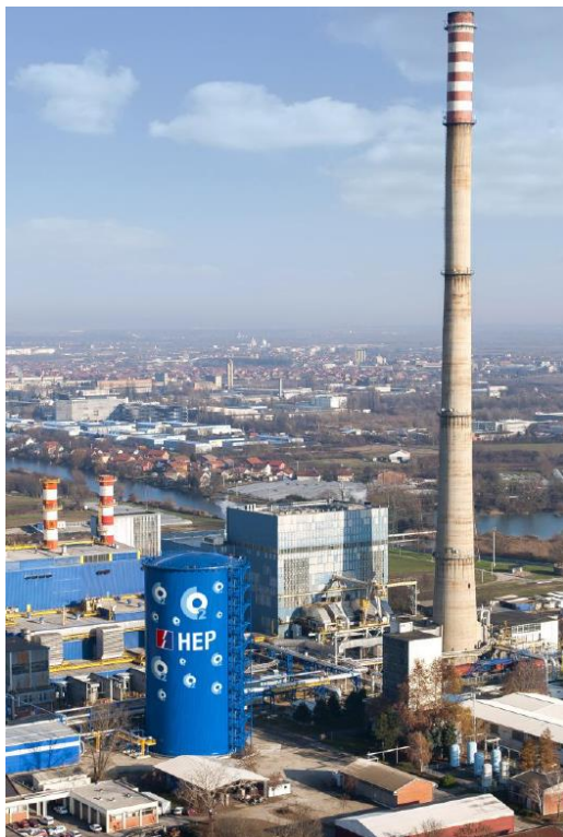
Slika 3.34. Akumulacijski stratifikacijski spremnik osjetne topline TE-TO Zagreb
