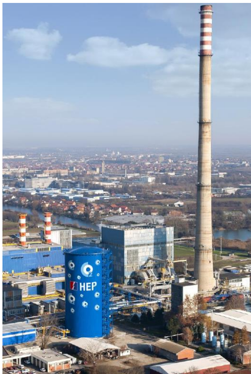
Slika 3.34. Akumulacijski stratifikacijski spremnik osjetne topline TE-TO Zagreb
