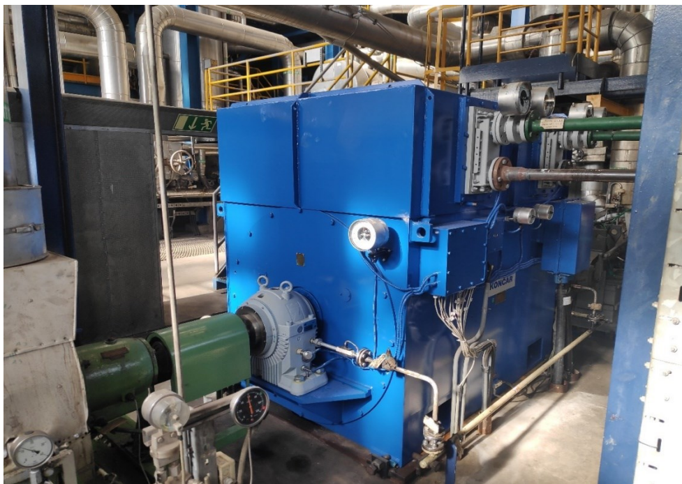
Slika 3.1. Najveći visokonaponski elektromotor u postrojenju termoelektrane Plomin II
