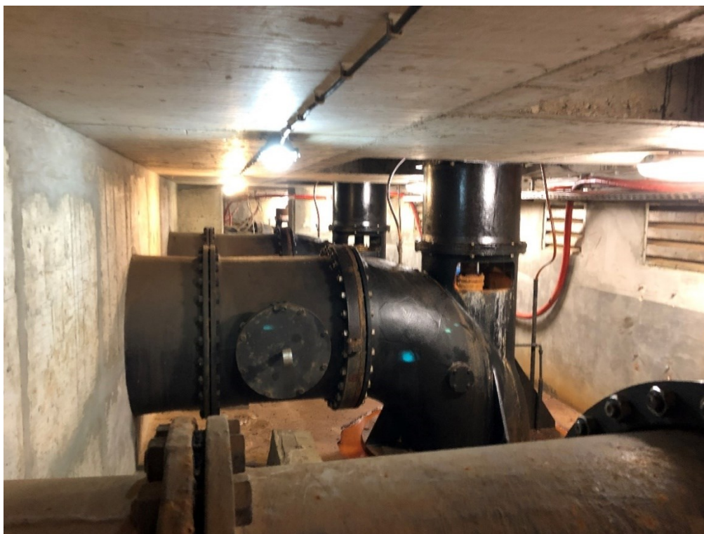
Slika 6.4. Pumpe morske vode u crpnoj stanici na izlazu Plominskoj zaljeva
