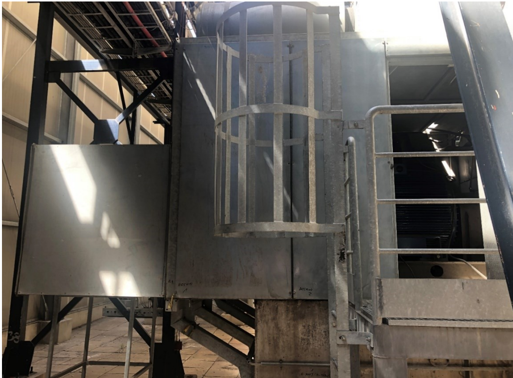
Slika 6.9. Elektromotor ventilatora toplog zraka obložen bukobranom
