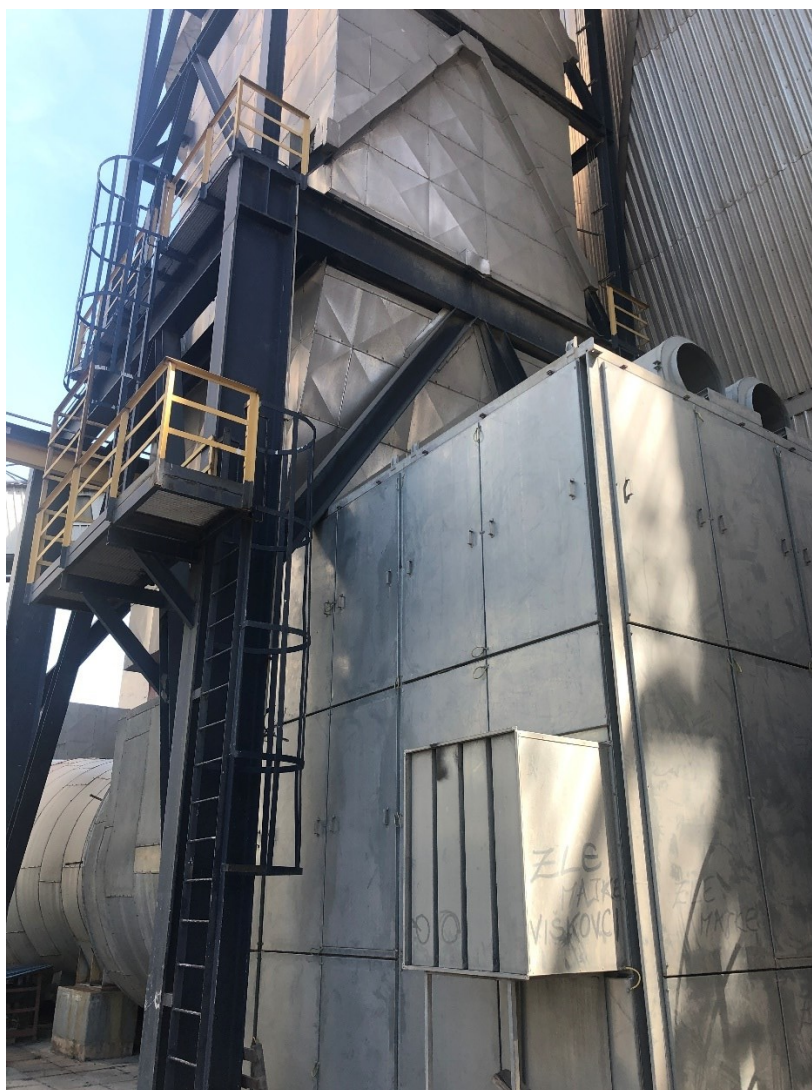
Slika 6.8. Elektromotor dimnog plina obložen bukobranom
