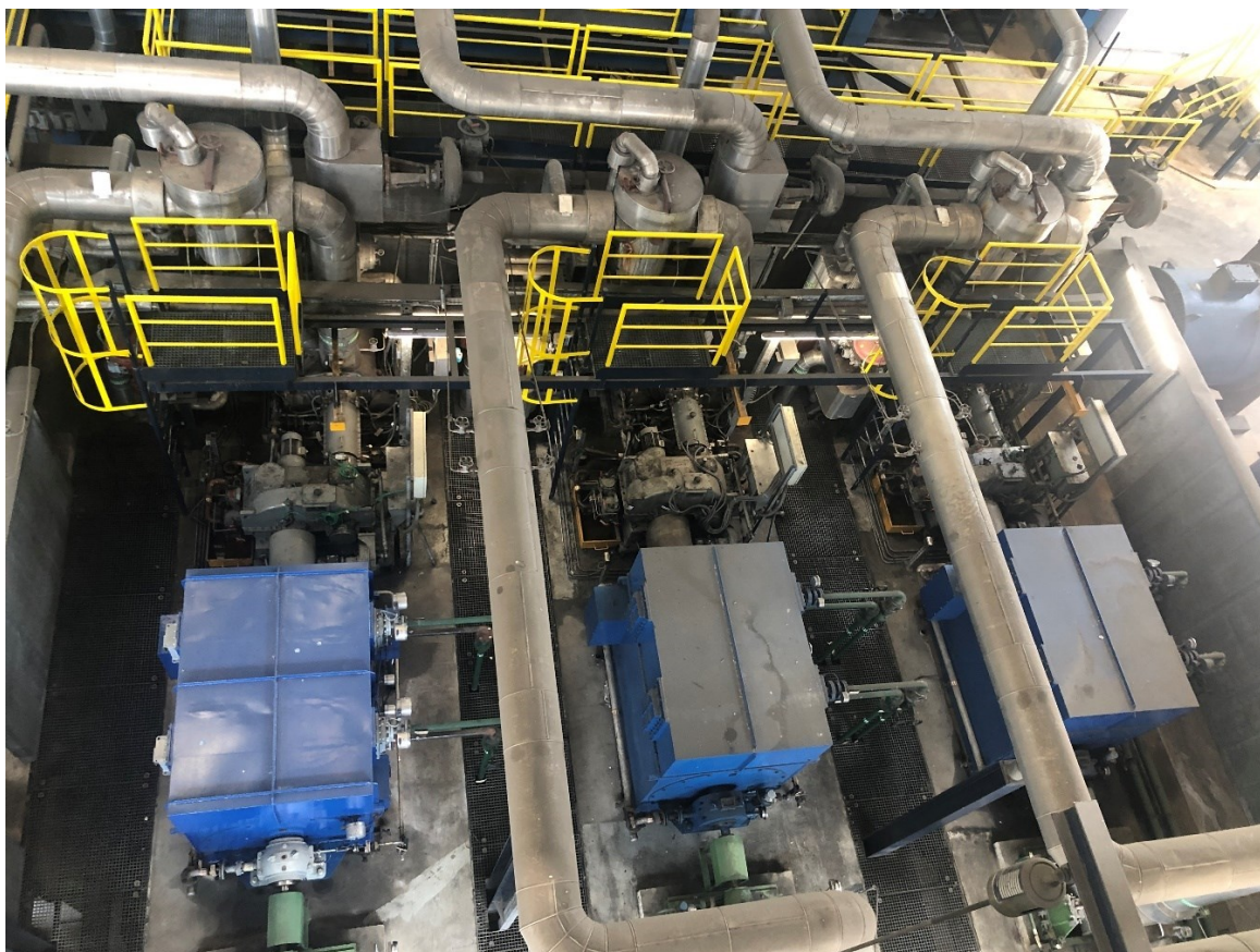
Slika 6.1. Elektromotori napojnih pumpi svaki snage 4100 kW
