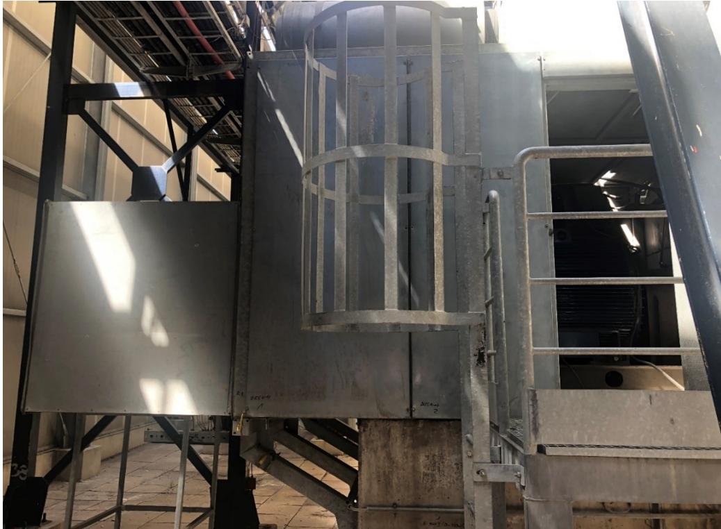
Slika 6.9. Elektromotor ventilatora toplog zraka obložen bukobranom
