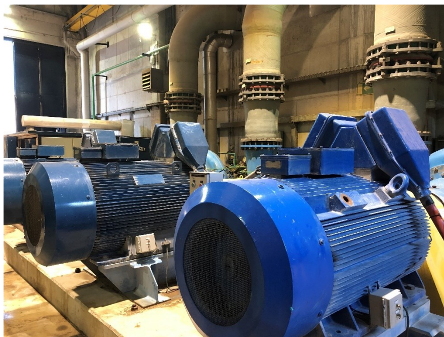
Slika 6.5. Elektromotori za pogon pumpi apsorbira
