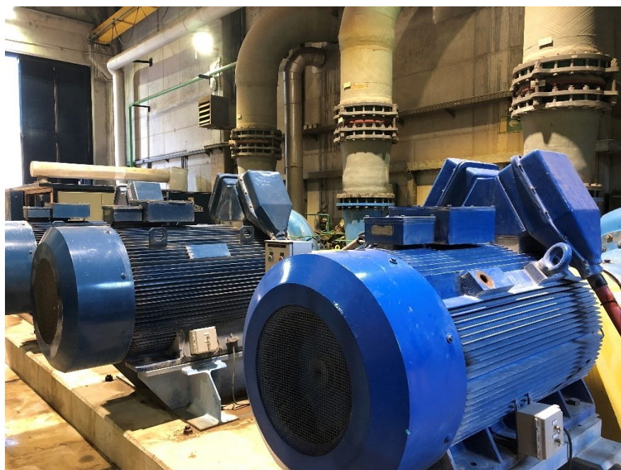
Slika 6.5. Elektromotori za pogon pumpi apsorbere
