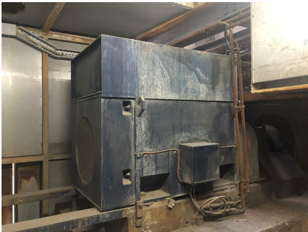
Slika 6.10. Elektromotor ventilatora recirkulacije dimnih plinova
