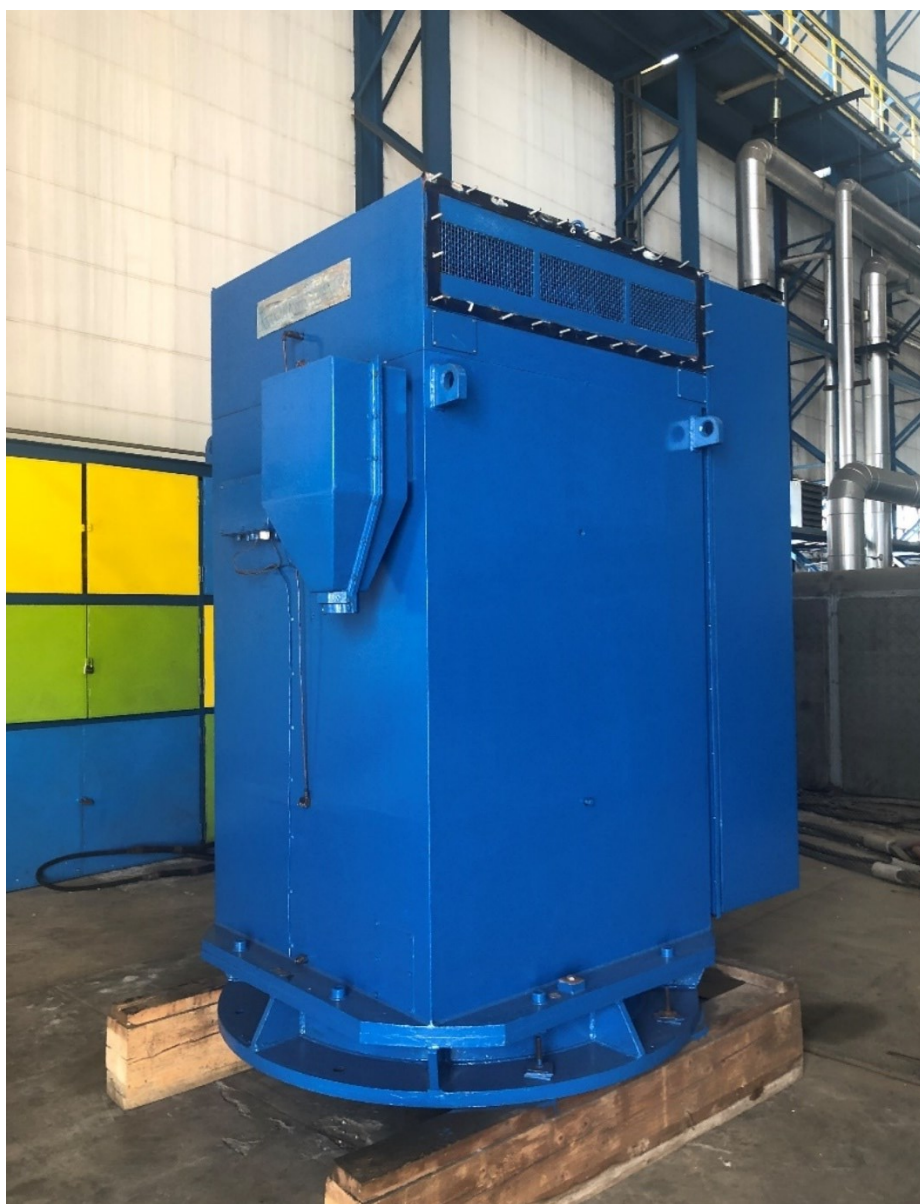
Slika 6.3. Elektromotor pumpe morske vode nakon servisiranja
