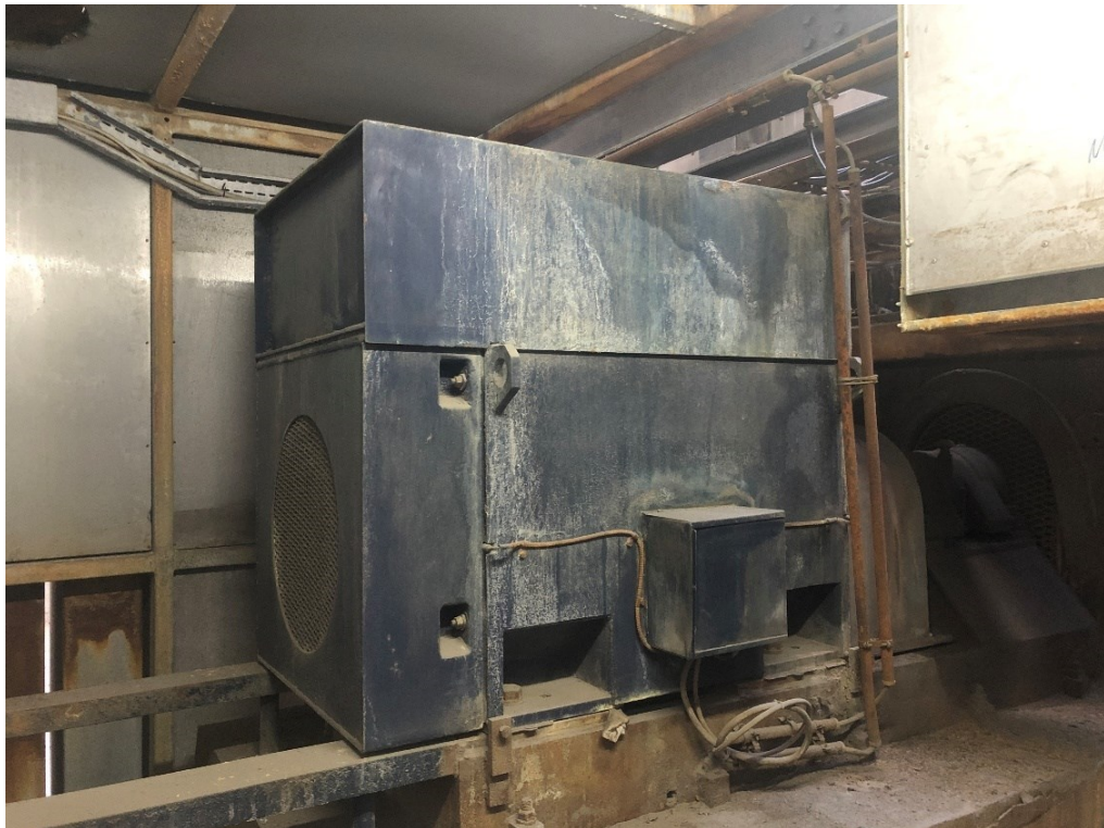
Slika 6.10. Elektromotor ventilatora recirkulacije dimnih plinova
