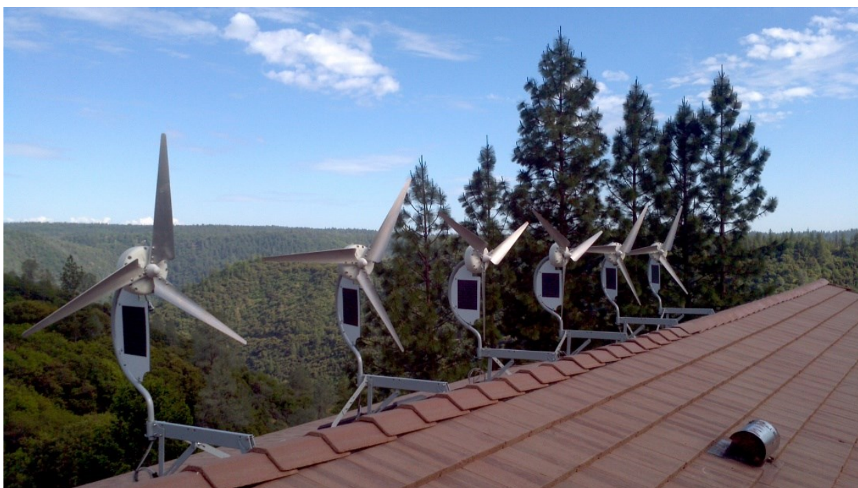
Slika 3.4. Vjetroturbine na krovu kuće
