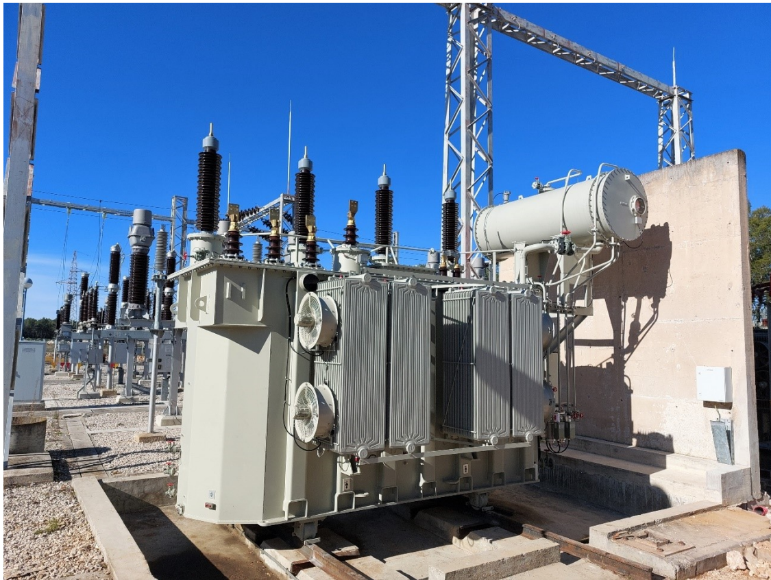
Slika 2.4. Energetski transformator nazivnog napona 110/10,5(21) kV tvrtke KONČAR D&ST
