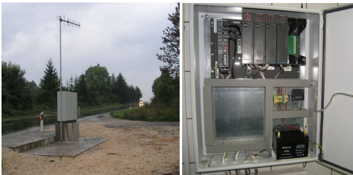
Slika 5.7. Lijevo RTU ormarić na otvorenom, desno oprema ormarića [12]
