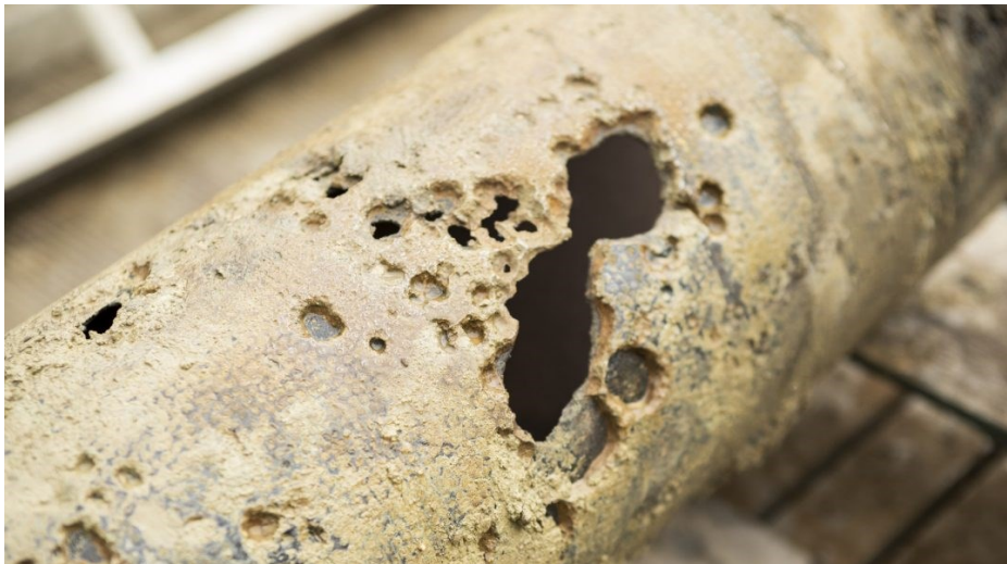
Slika 2.16. Primjer rupičaste korozije na cijevi [18]
