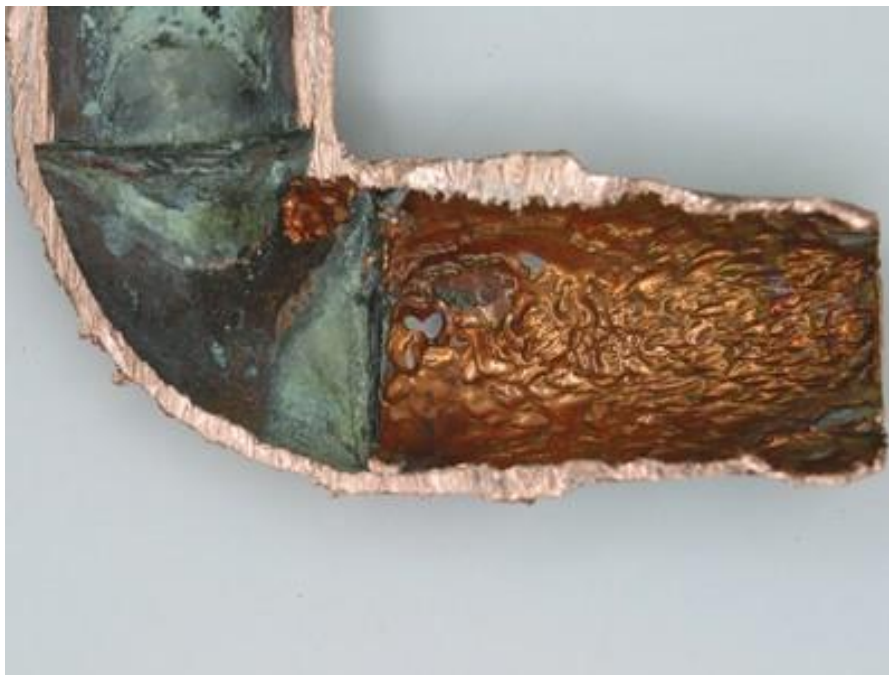
Slika 3.20. Erozijska korozija unutrašnjosti bakrene cijevi [41]
