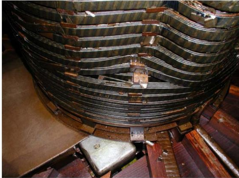
Slika 3.8. Primjer deformacije sredjenaponskog namota [2]
