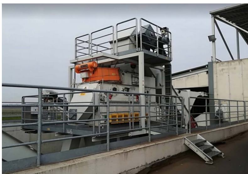
Slika 4.5. Primjer pužnog sustava do kotlovnice
