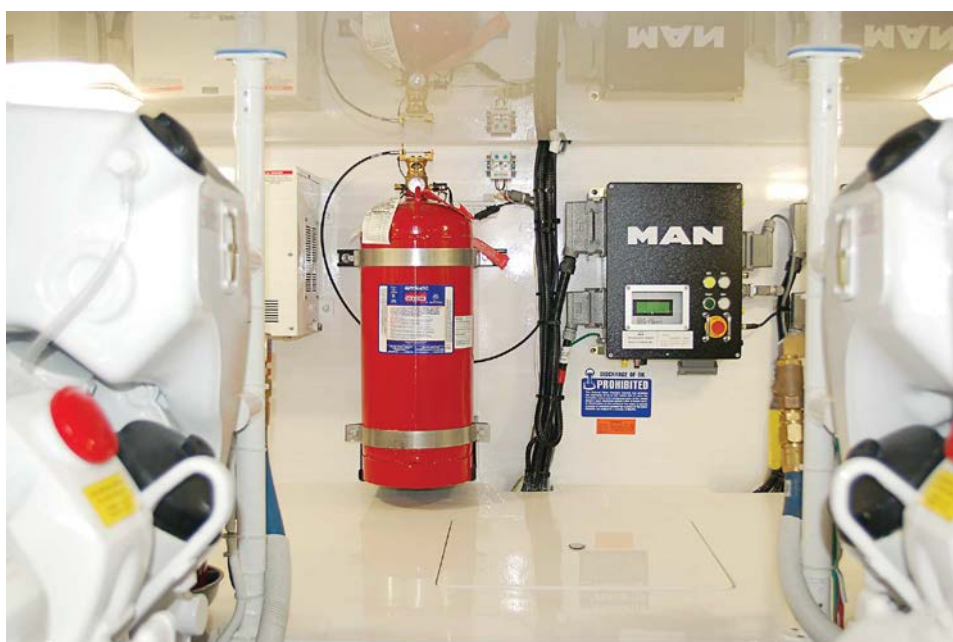
Slika 3.3.2.1.: Fiksni sustav za gašenje požara u strojarnici
