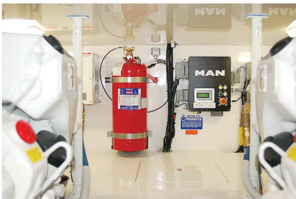
Slika 3.3.2.1.: Fiksni sustav za gašenje požara u strojarnici
