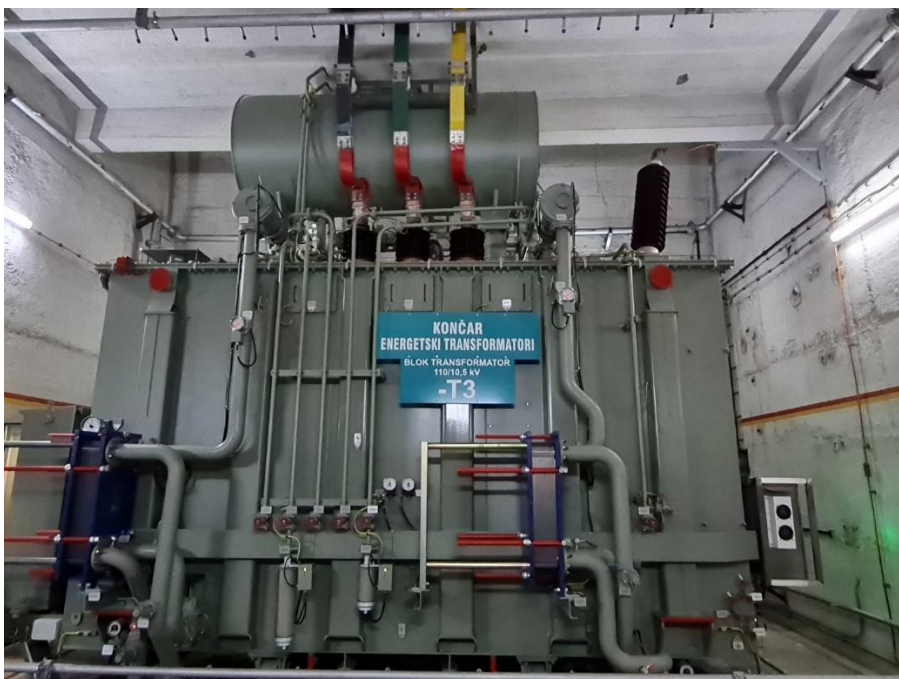
Slika 2.1. Energetski transformator 110/10,5 kV u HE Senj
