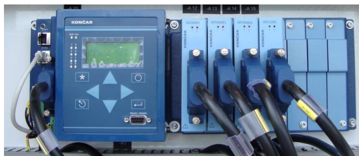
Slika 5.8. Kontroler s I/O modulima [12]
