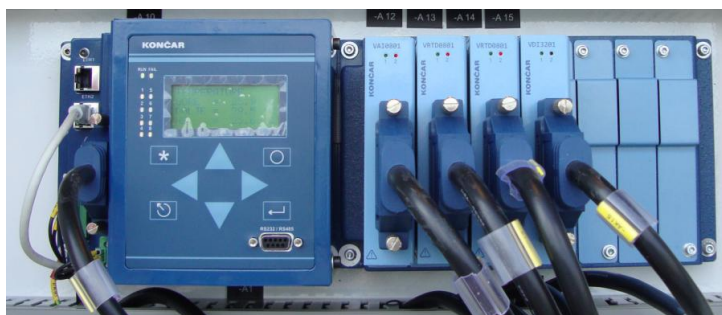
Slika 5.8. Kontroler s I/O modulima [12]
