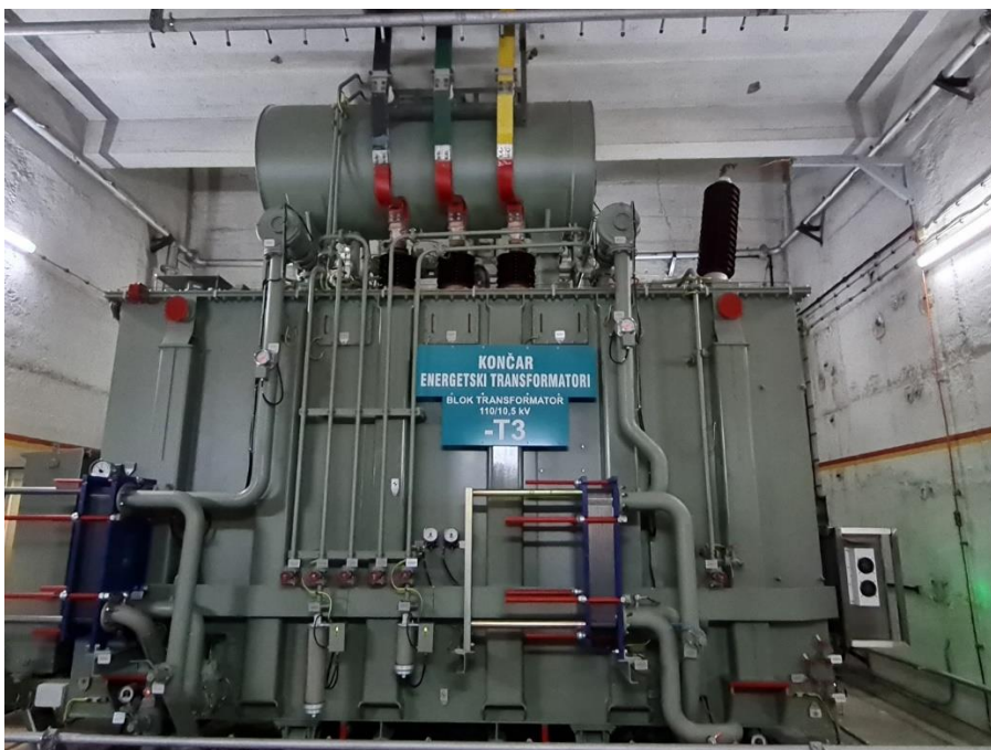
Slika 2.1. Energetski transformator 110/10,5 kV u HE Senj
