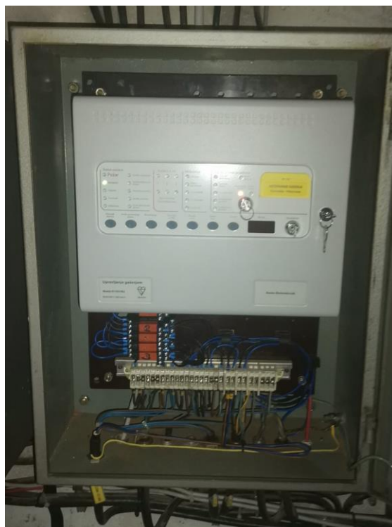
Slika 3.5. Prikaz protupožarne centrale
