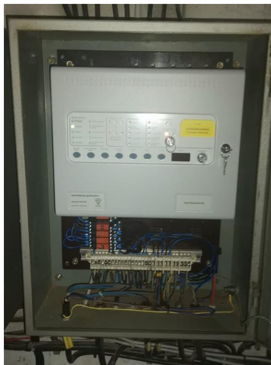
Slika 3.5. Prikaz protupožarne centrale
