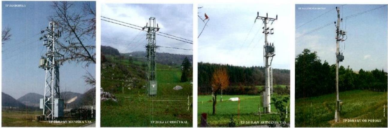
Slika 4.3. Prikaz „stupnih“ transformatorskih stanica. Izvor: [7]
