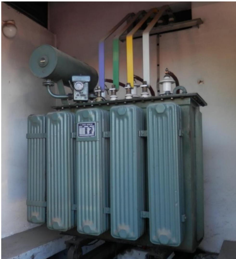
Slika 5.7. Stara izvedba transformatora snage 400 kVA.
