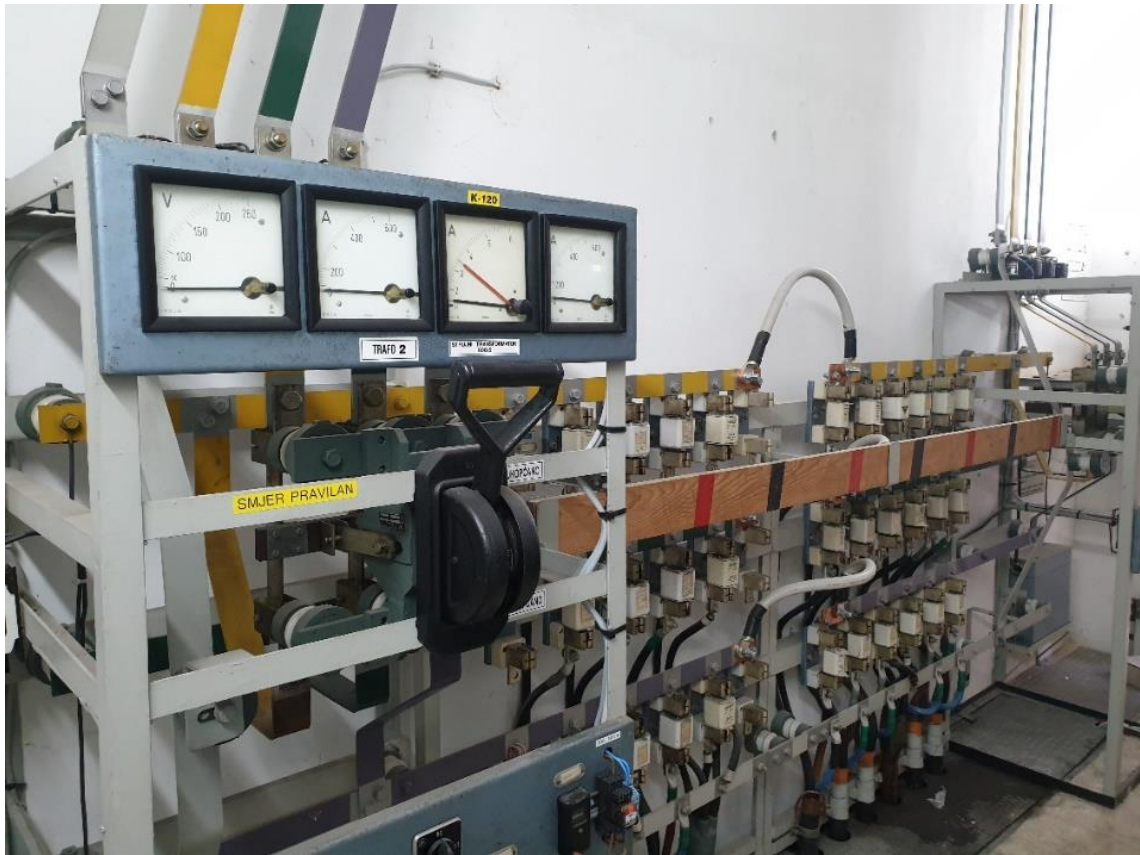
Slika 5.5. Stara izvedba NN bloka u TS Omladinska.
