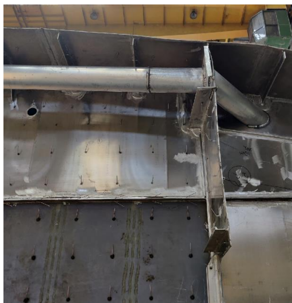
Slika 10.1. Upora na aluminijskoj strukturi
