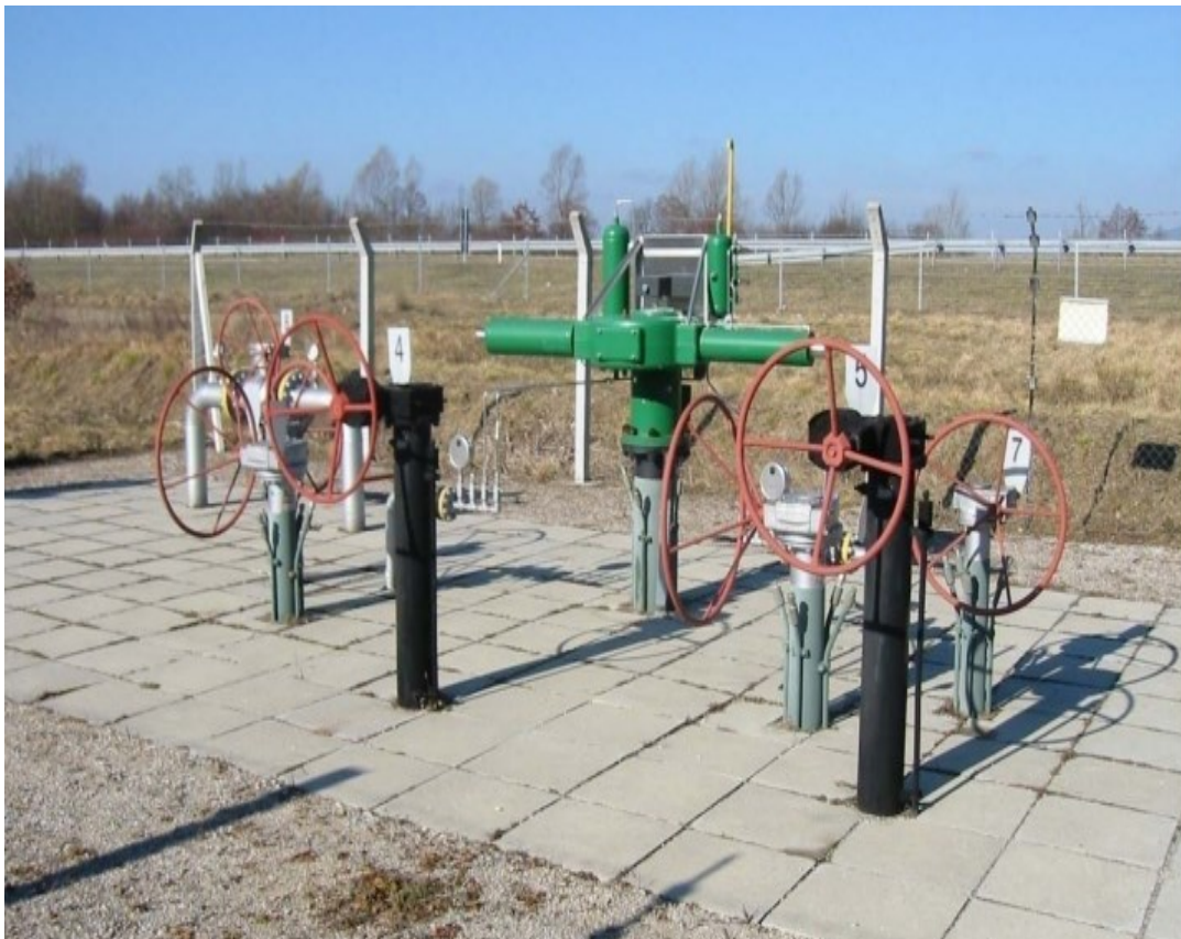
Slika 5.1. Blokadna stanica Jastrebarsko [2]
