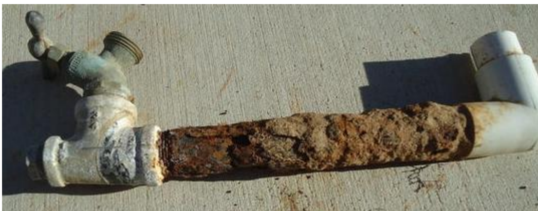
Slika 5.29. Galvanska korozija pocinčane čelične cijevi [52]
