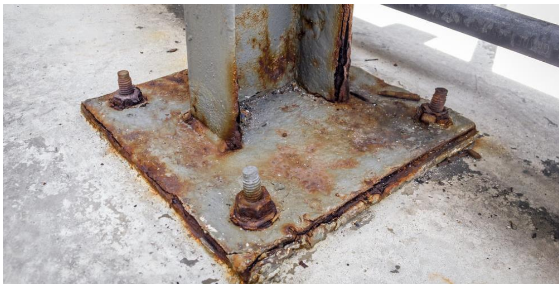
Slika 5.24. Korozija u procijepu kod čeličnog stupa [47]
