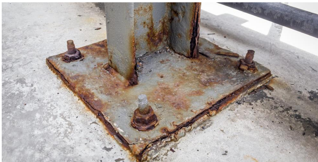
Slika 5.24. Korozija u procijepu kod čeličnog stupa [47]
