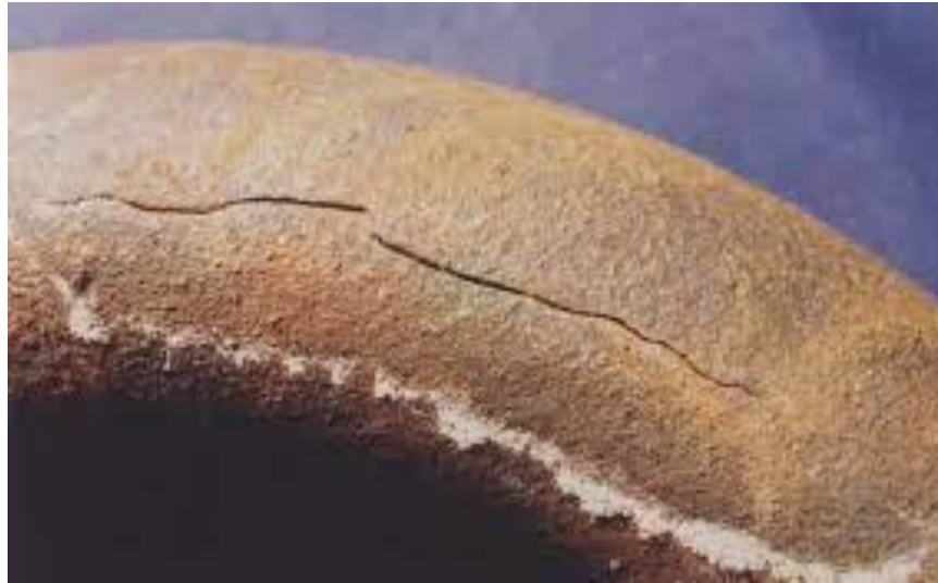
Slika 5.14. Napetosna korozija na savijenom dijelu cijevi [35]
