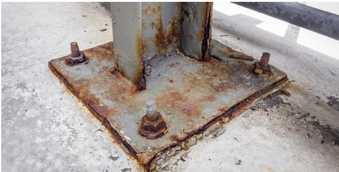
Slika 5.24. Korozija u procijepu kod čeličnog stupa [47]
