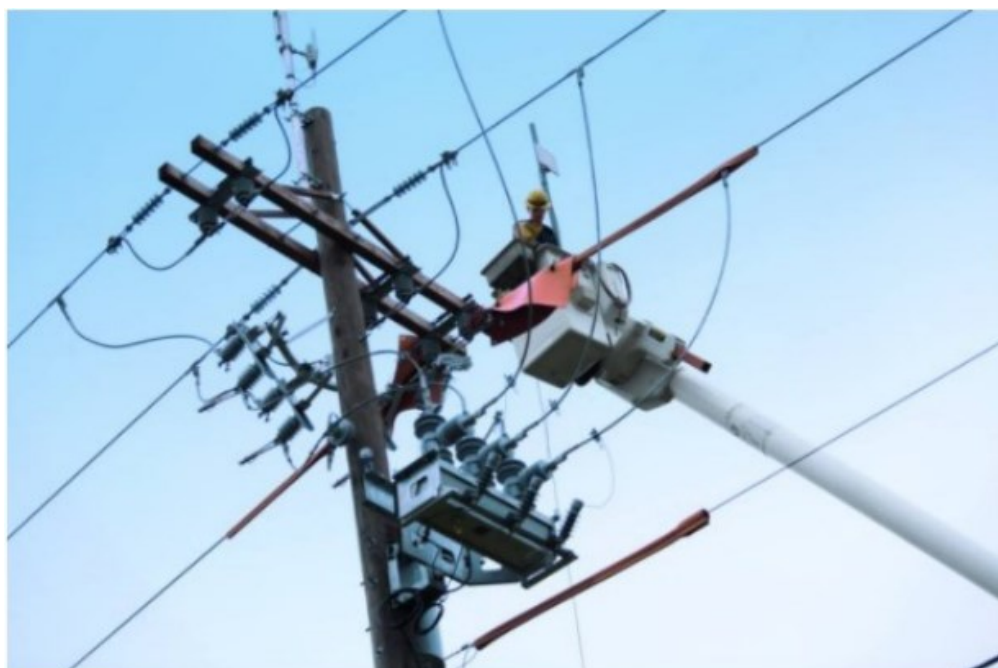
Slika 3.6. Vakuumski prekidač na nadzemnom distribucijskom vodu [12]
