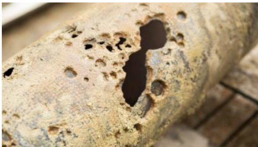
Slika 4.1 Rupičasta korozija na cijevi
