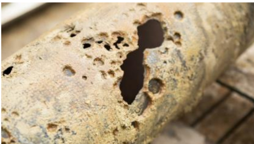
Slika 4.1 Rupičasta korozija na cijevi
