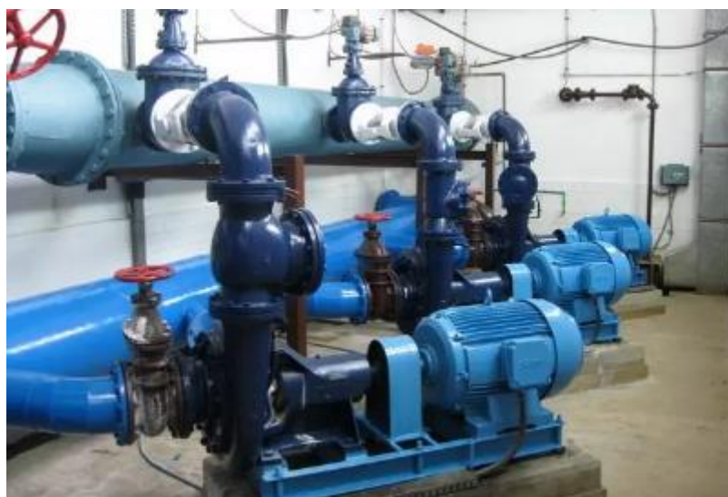
Slika 2.3. Crpna stanica za vodovod
