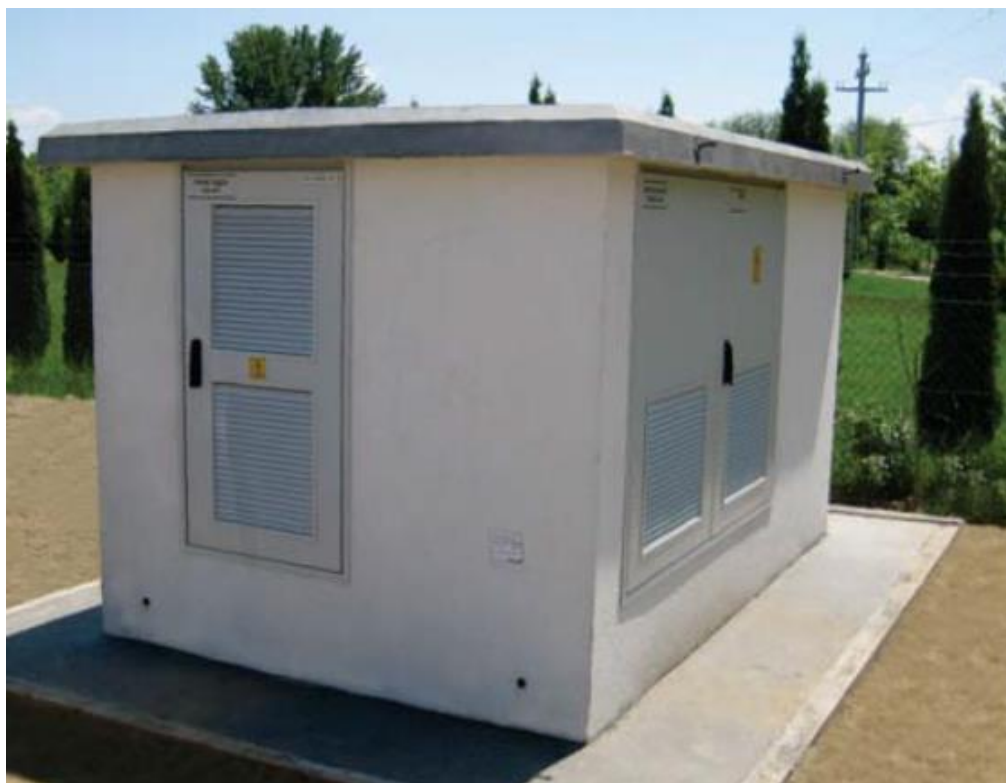
Slika 5.6 Primjer TS 20(10)/0.4 kV, 630 kVA [21]
