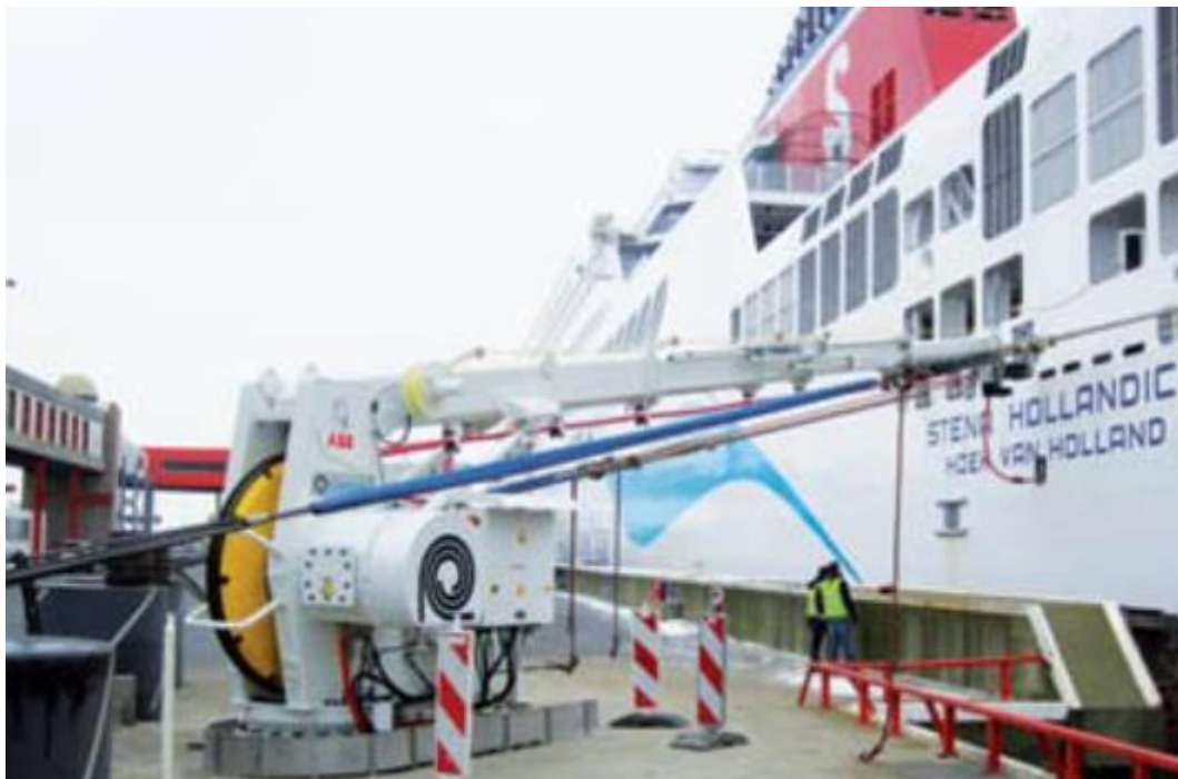
Slika 4.2 Priključenje broda Stena Hollandica na kopneni priključak [15]
