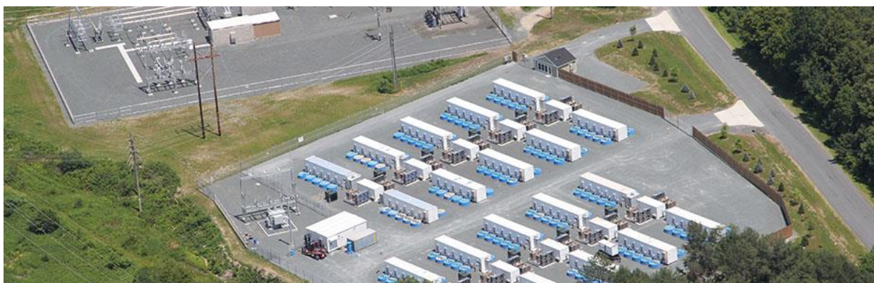
Slika 3.4. Postrojenje u Stephentown, New York (NY), SAD [27]
