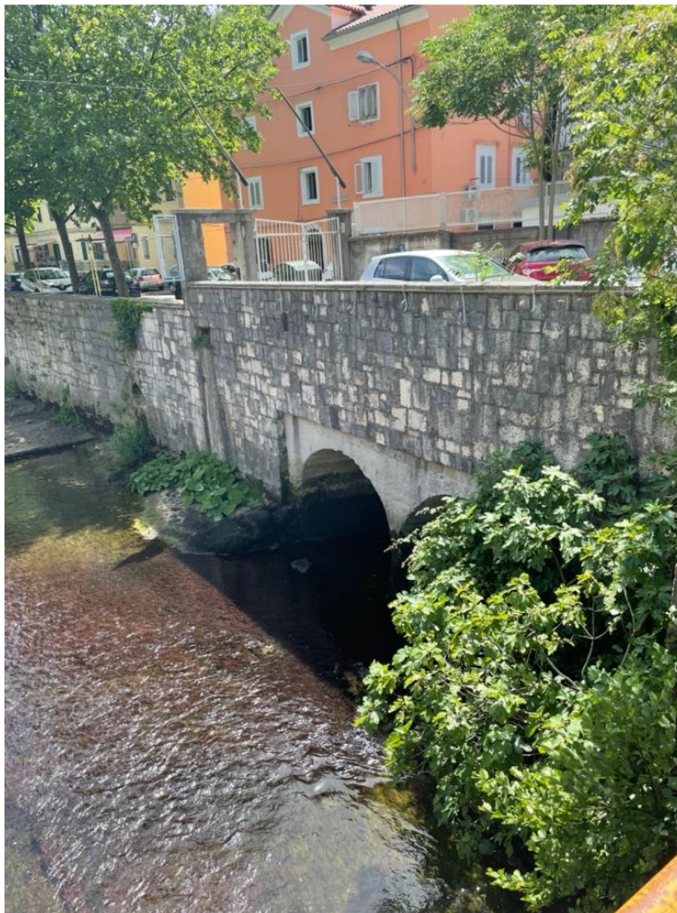
Slika 3.9. Ispust iz odvodnog kanala HE Rijeka
