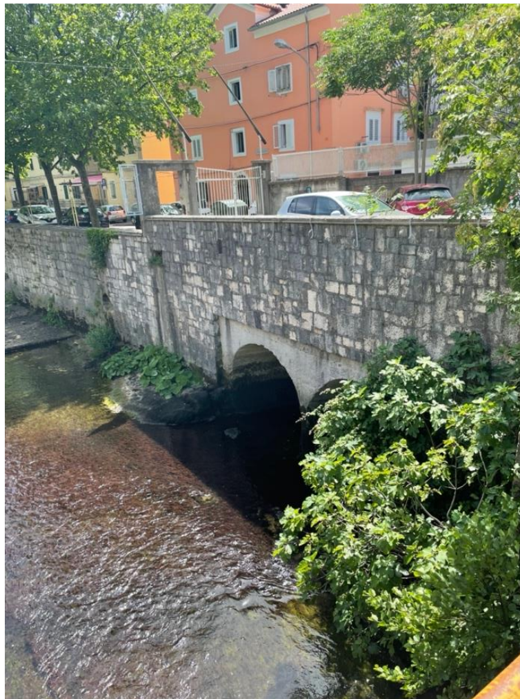
Slika 3.9. Ispust iz odvodnog kanala HE Rijeka
