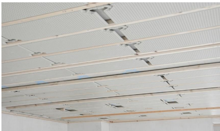
Slika 3.7 Harreither Jumboval stropno hlađenje [10]
