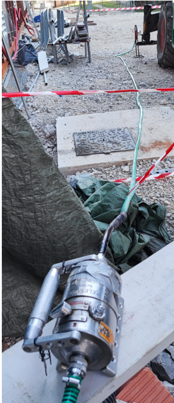
Slika 4.17. Postavljeni daljinski upravljač
