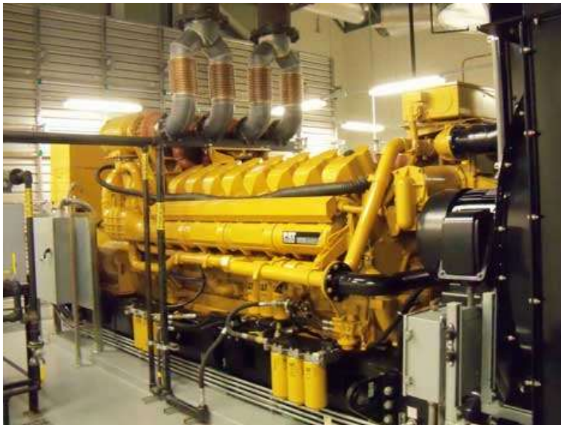
Slika 3.2. Pomoćni dizelski generator [4]
