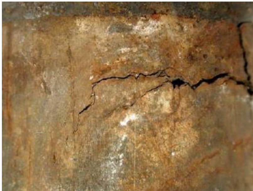
Slika 2.19. Lom izazvan napetosnom korozijom [5]
