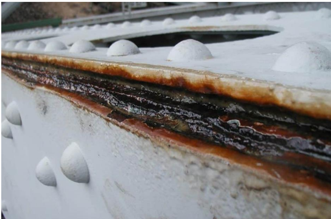
Slika 2.2. Korozija u procjepu kod avionskog dijela [5]
