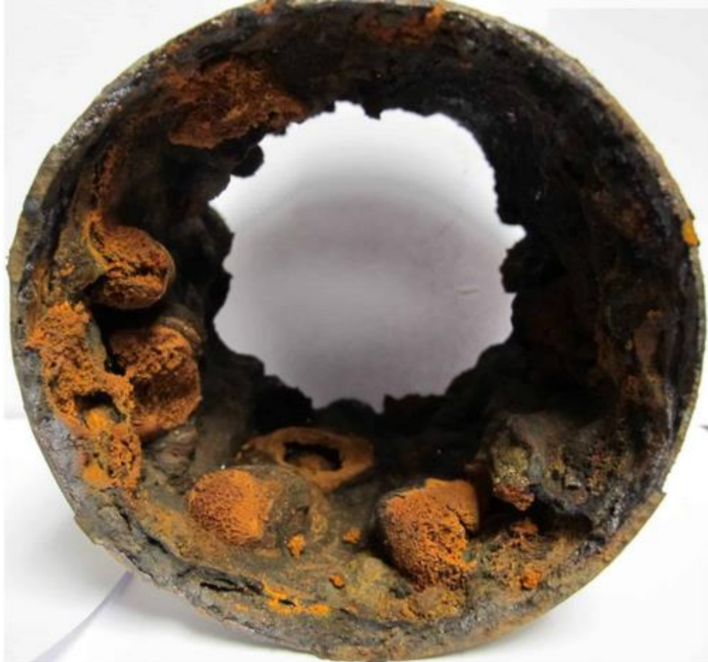
Slika 2.18. Biološka korozija u cijevi [7]
