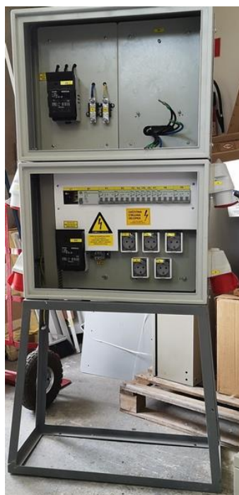
Slika 3.13. Razdjelni ormar privremenog priključka za gradilište marke EL-COMM [9]
