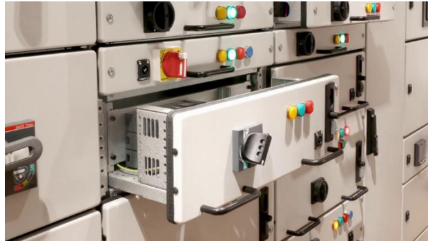
Slika 3.7.. Razdjelni distribucijski ormar marke Duplenco [6]
