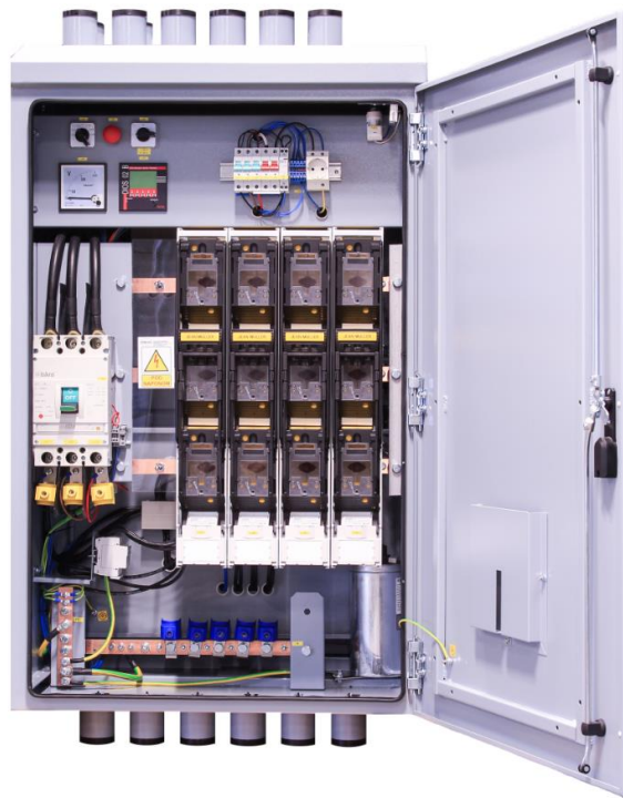
Slika 3.5. Razdjelni ormar marke Work-ing [2]
