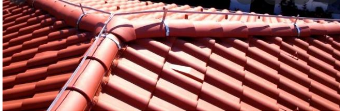
Slika 3.8. Gromobranska instalacija na krovu zgrade
