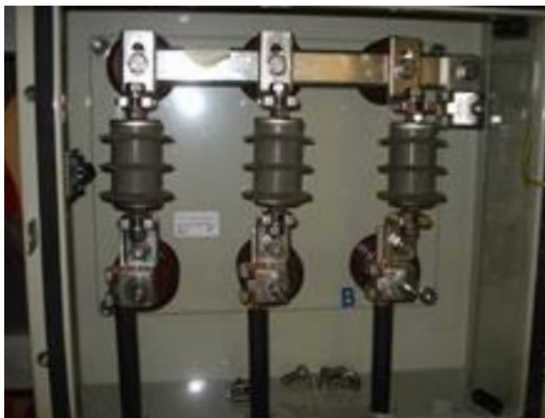
Slika 5.8. Ormar s odvodnicima prenapona za uzemljivanje kablenskog zaslona
