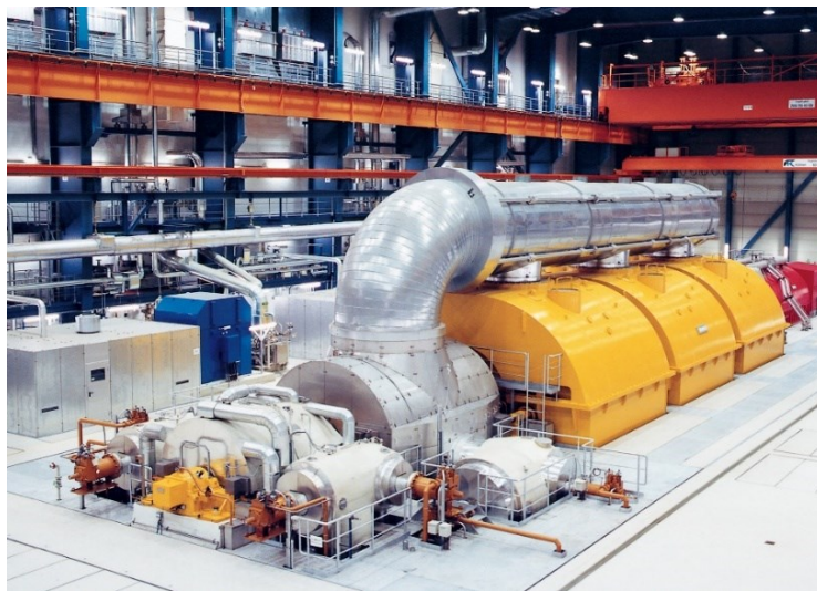
Slika 2: Turbogenerator snage 500MW [2]
