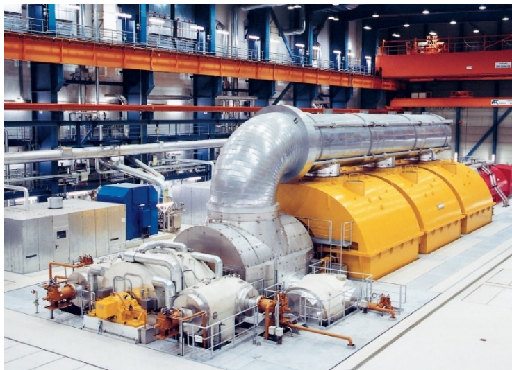
Slika 2: Turbogenerator snage 500MW [2]
