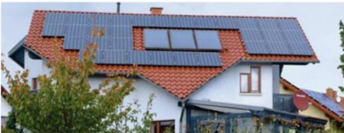
Slika 2.3 Fotonaponski sustav na krovu kuće [15]
