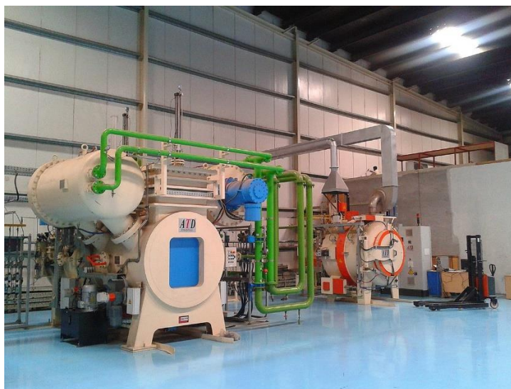
Slika 3.9. - Moderno postrojenje za pougličavanje u plinu [19]
