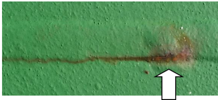
Figure 1 Crack at the weld toe Slika 1 Pukotina na rubu šava zavarenog spoja
