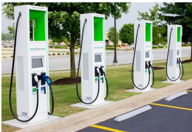
Slika 3.1. Punionica električnih vozila spojena na mrežu
