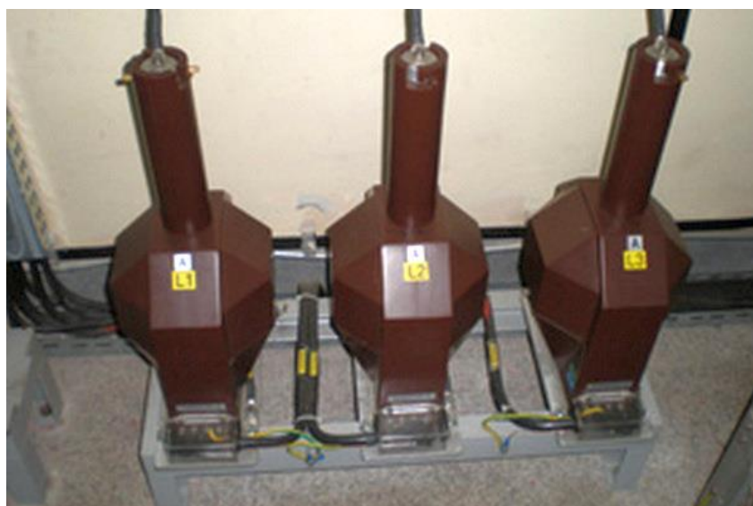
Slika 3.13. VPA naponski mjerni transformator
