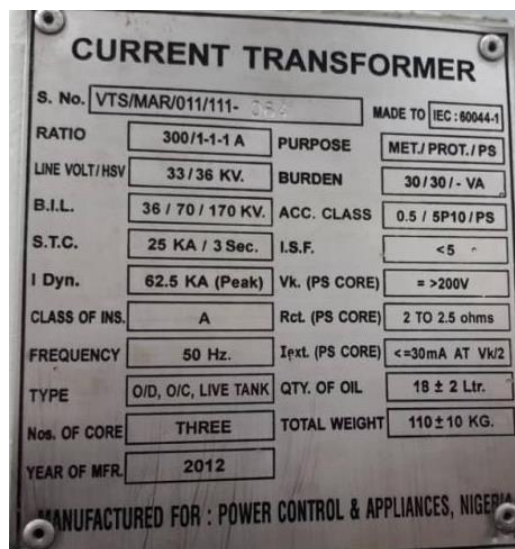
Slika 4.7. Natpisna pločica strujnog mjernog transformatora [3]
