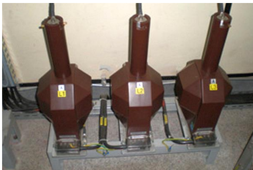
Slika 3.13. VPA naponski mjerni transformator
