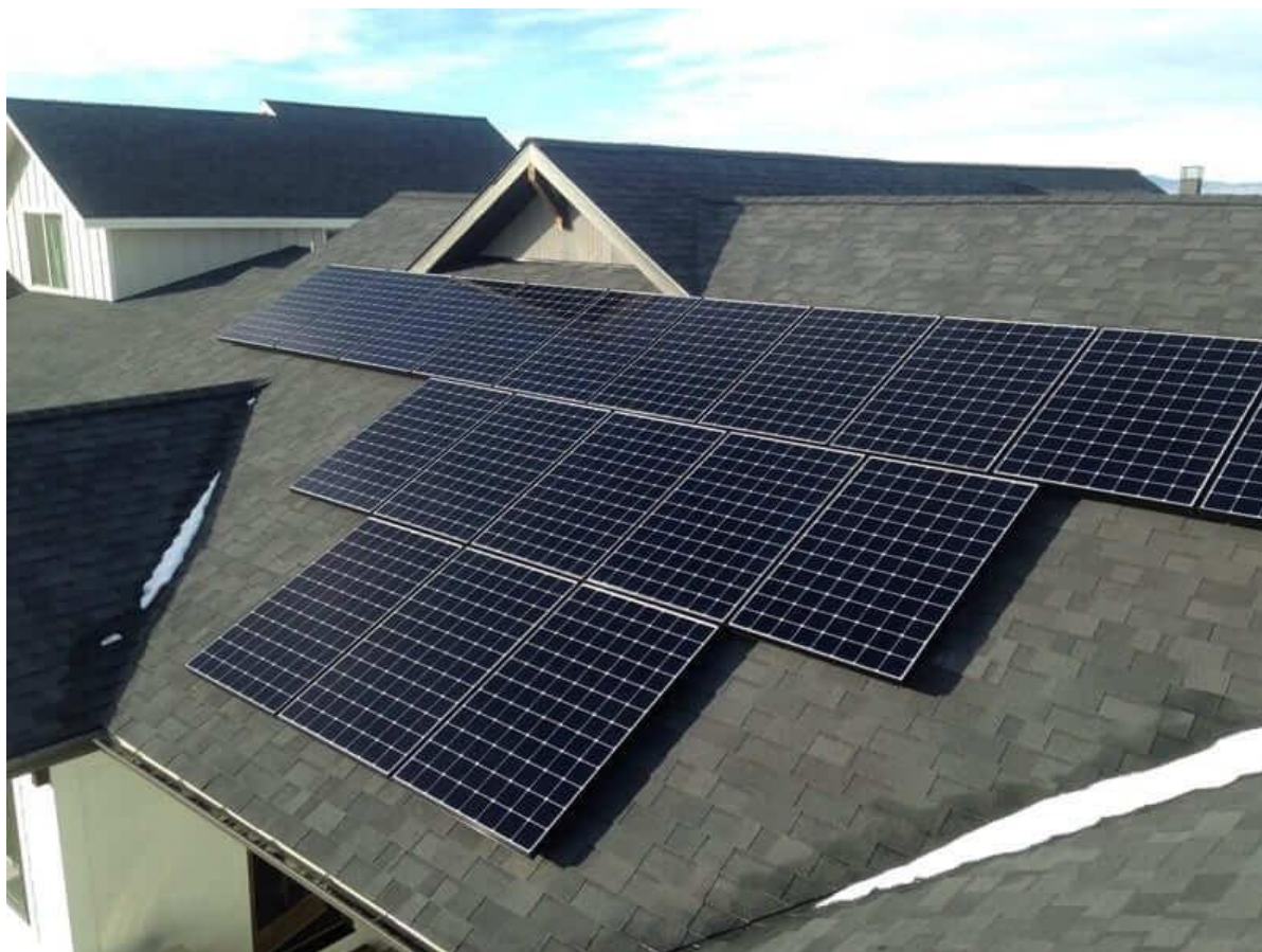
Slika 3.5. Slika fiksnih krovnih solarnih panela [21]
