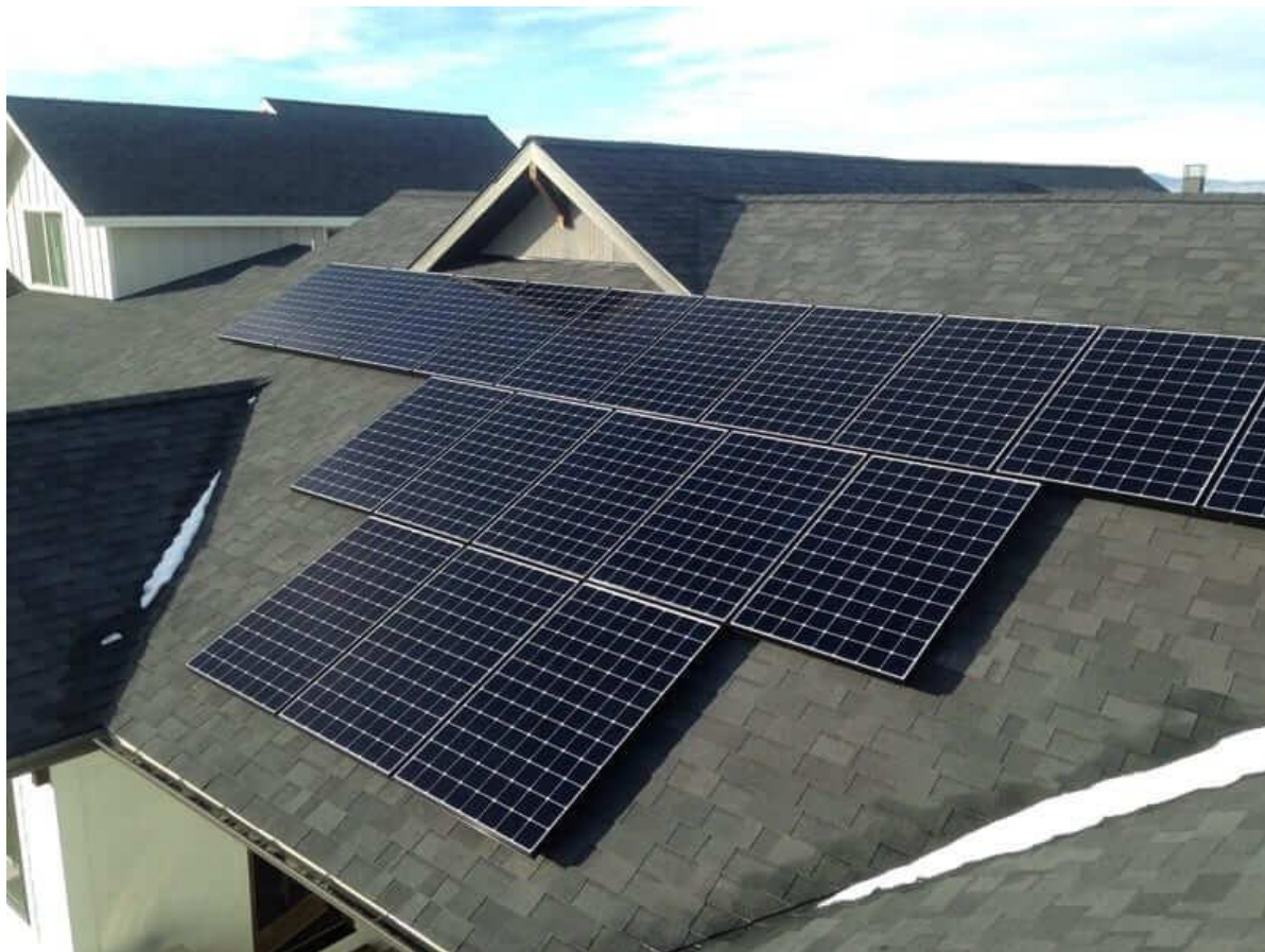
Slika 3.5. Slika fiksnih krovnih solarnih panela [21]
